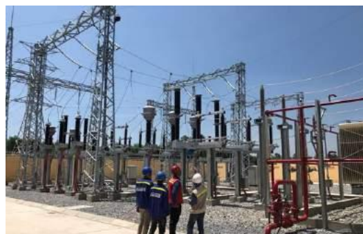
Trạm biến áp 110kV tại Nhà máy
