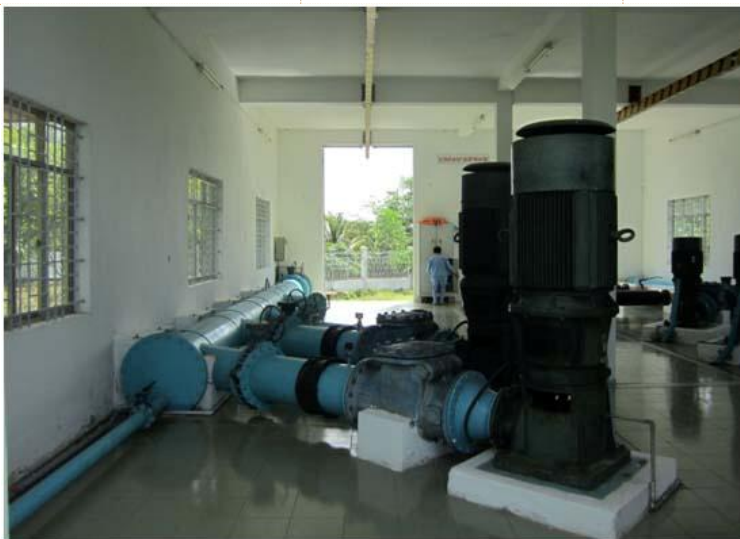
Hệ thống bơm nước sạch
