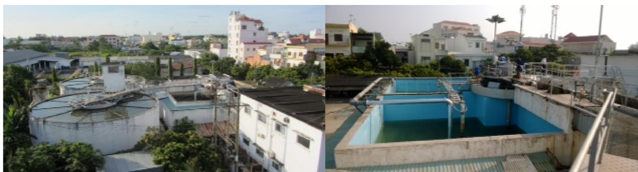
Hình ảnh Cụm xử lý nước
