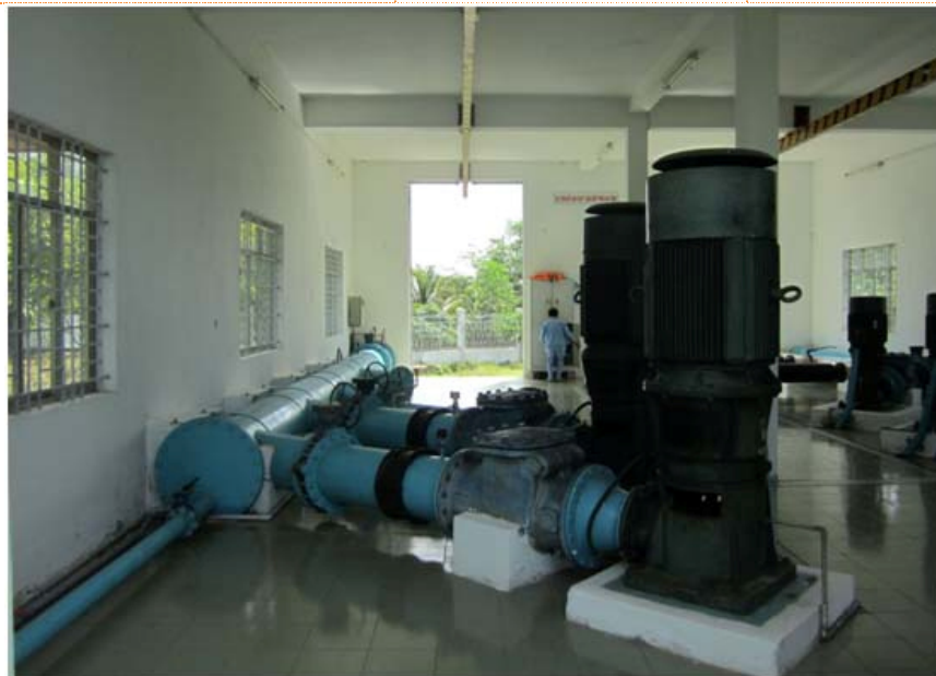
Hệ thống bơm nước sạch
