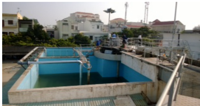
Hình ảnh Cụm xử lý nước
